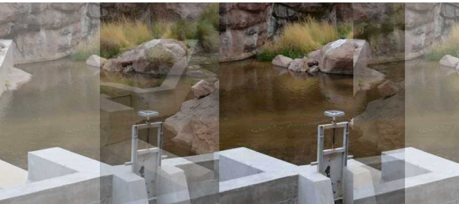
Obra de toma Programa Hidroenergético, IHH-UMSA
